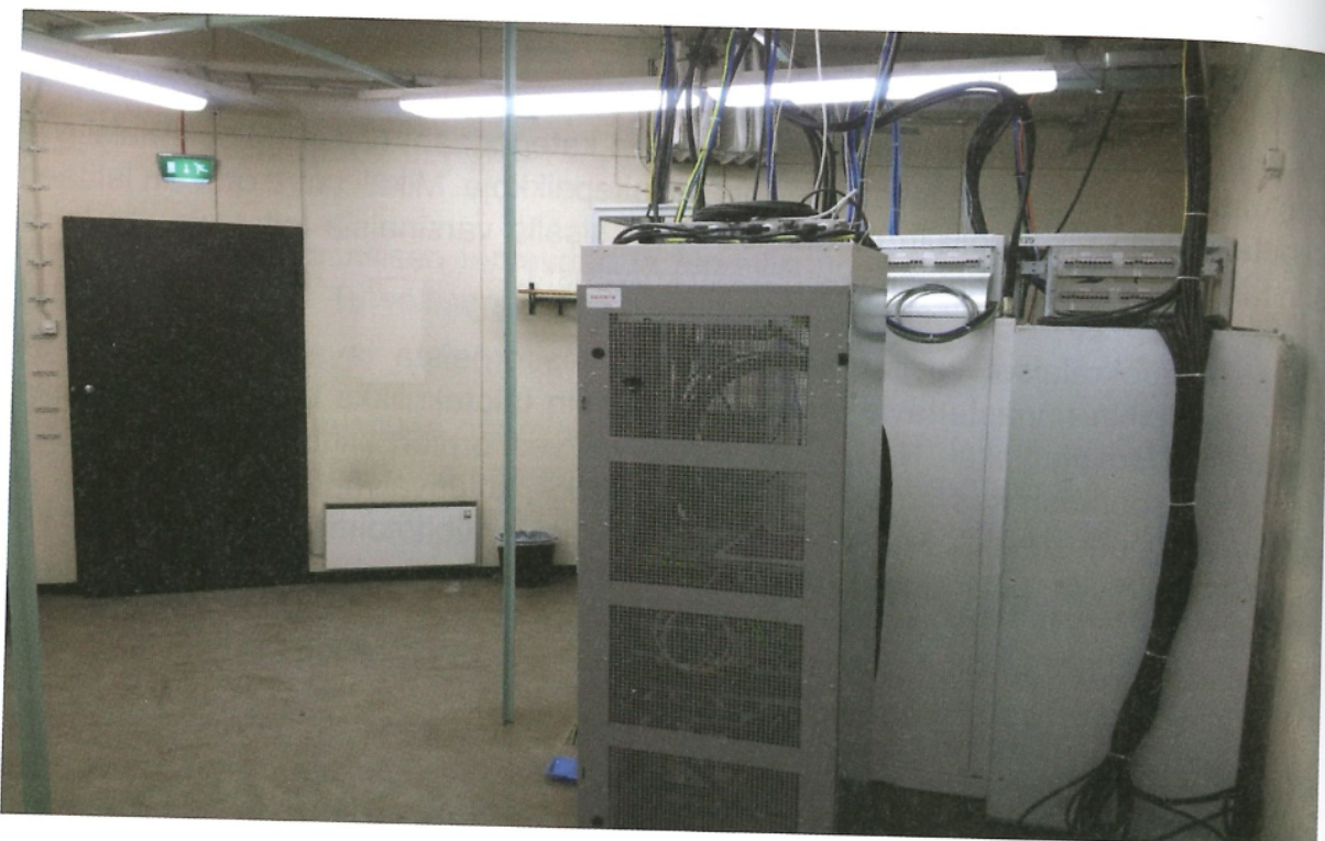
Kuva 2.3. Kauniaisten vesitornissa sijaitseva laitetila.
