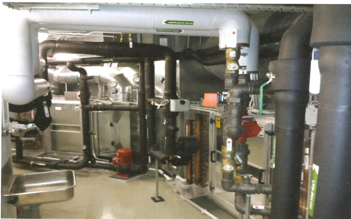
Kuva 2.2. Ravintolatilosta johtuvaa talotekniikkaa Haukilahden vesitornissa.
