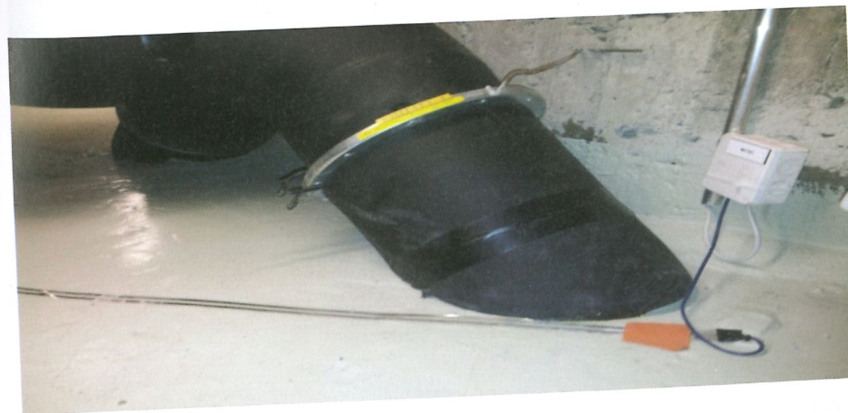
Kuva 2.5. Kosteusanturi Haukilahden vesitornissa.
